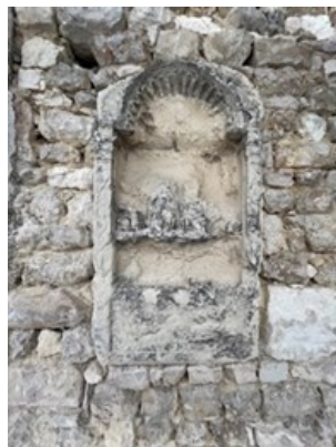
Bas-relief du collatéral Nord entièrement dégradé
