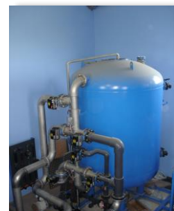
Traitement des nitrates
